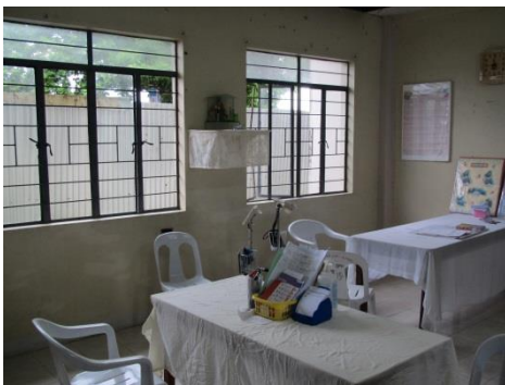
割れたままの窓ガラス
